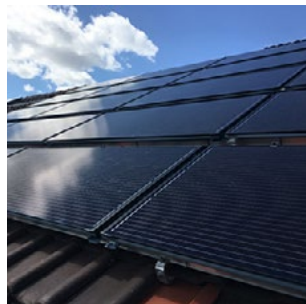
Abb. 58: PVT-Kollektoren auf dem Dach des Gebäudes
