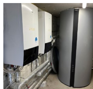
Abb. 68: Zwei Inneneinheiten der Wärmepumpe mit Pufferspeicher
